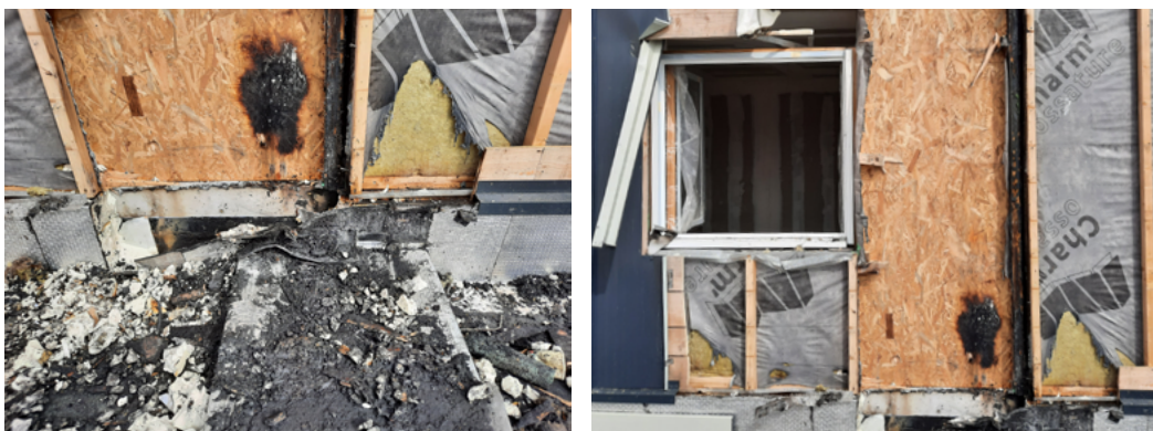
Exemple concret : départ de feu lors de la réalisation d'un relevé d'étanchéité au collège d'Ivry-sur-Seine (94)
